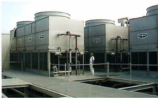
Abb. 3 Typische 15 MW geräuscharme ATC Verdunstungs-Verflüssigeranlage
